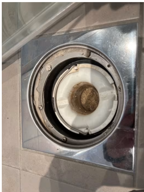
Baderomssluk plassert i dusjsone.
