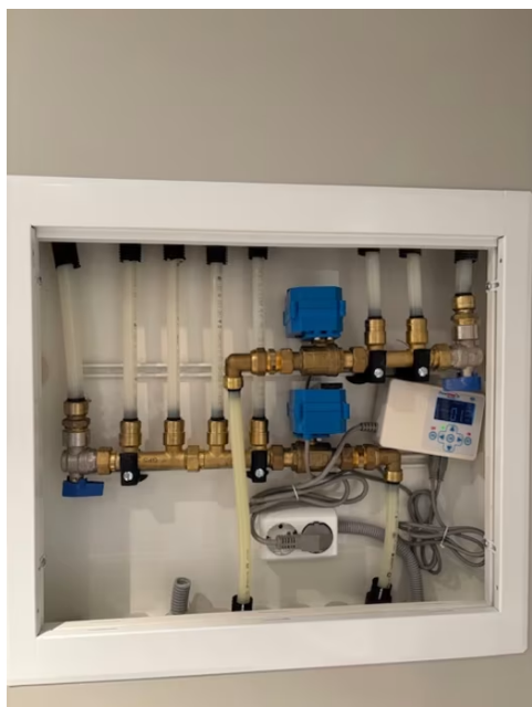
Rørfordelerskap med stoppekran plassert i gang.
