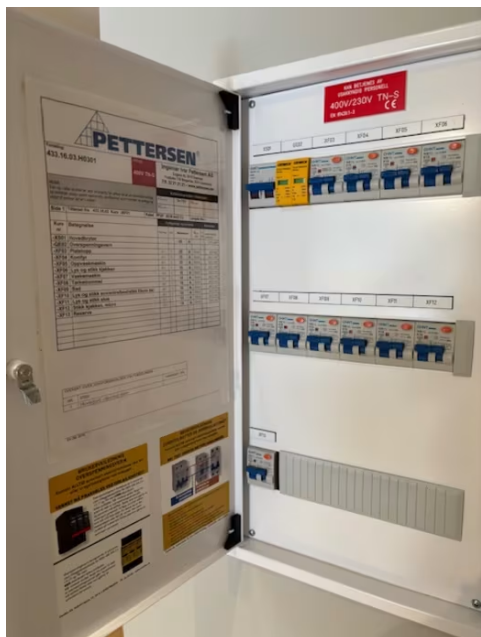
Sikringsskap med automatsikringer og kursfortegnelse plassert i gangen.
