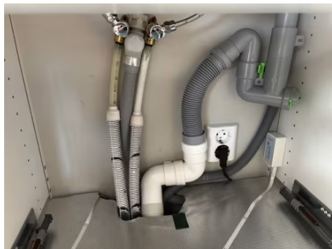
Avløpsrør i underskap vask på kjøkkenet.
