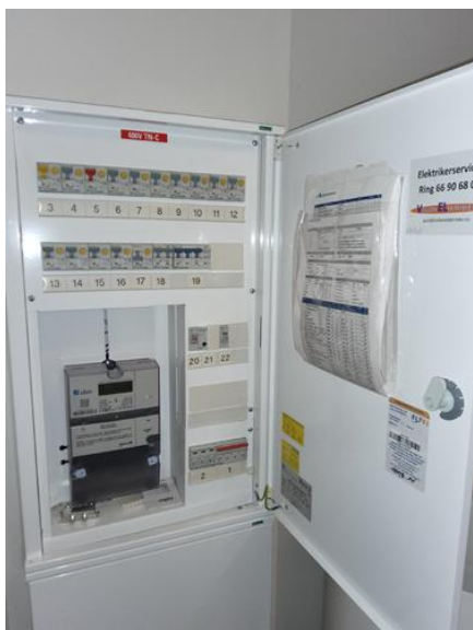
Elektrisk anlegg - [Sikringsskap]
