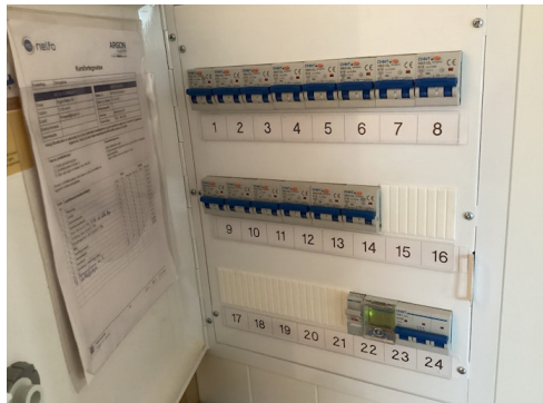
Bilde av Sikringskap
