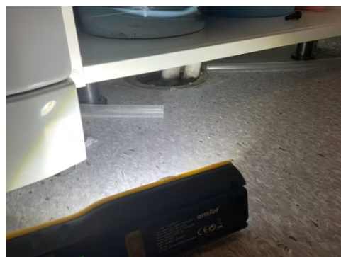
Sluk under benkeskap
