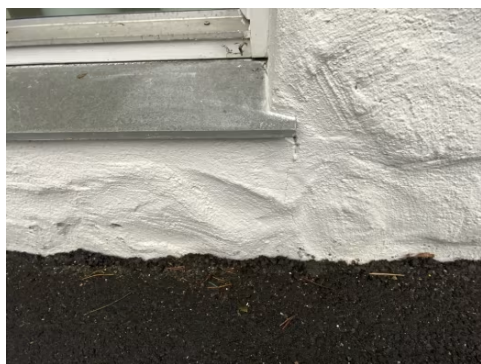
Riss i grunnmur under vindu
