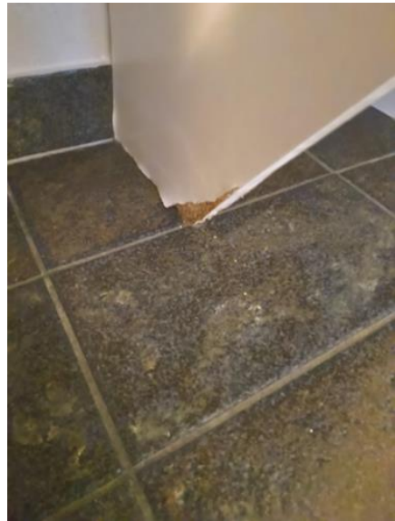
Sanitærutstyr / innredning - [Skap på bad i kjeller ]
