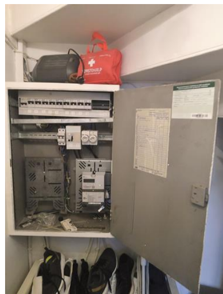
Elektrisk anlegg - [Sikringskap]
