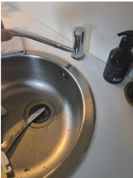
Innredning - [Blandebatteri på kjøkken i kjeller ]
