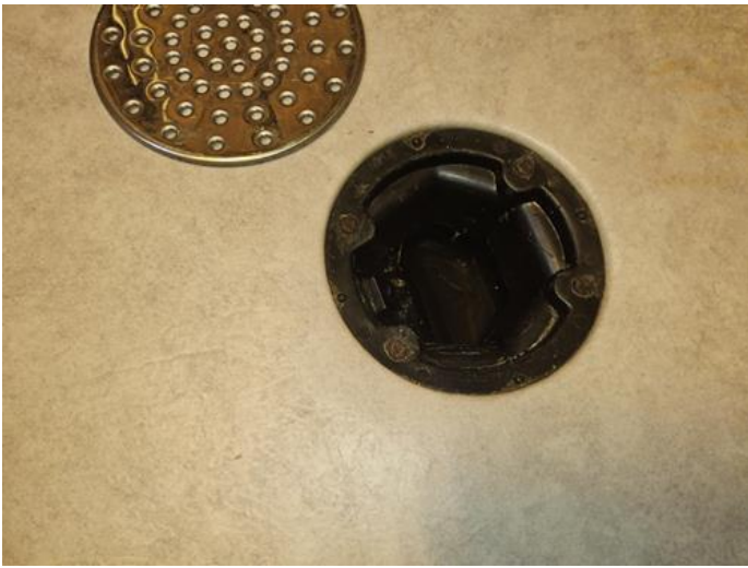
Avløpsrør (ink. sluk) - [Sluk vaskerom]
