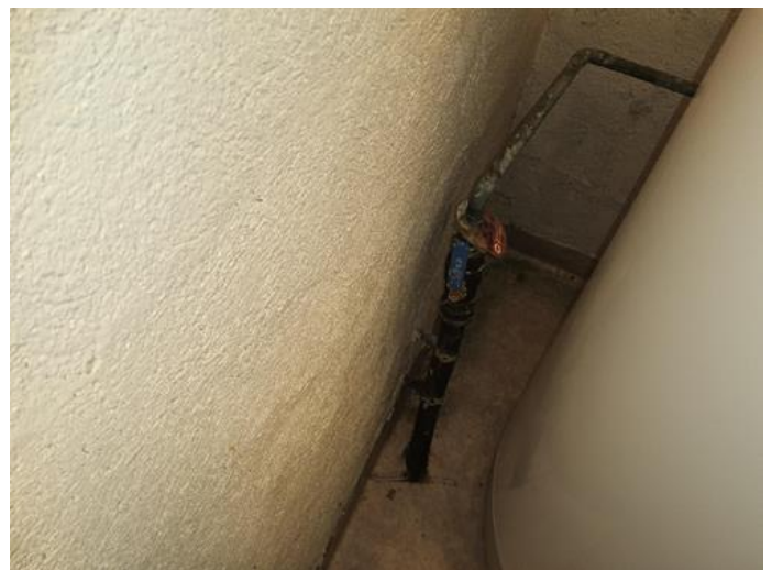
Tekniske anlegg, VVS anlegg (Sjekkpunkter utover det som er inkludert i andre rom) - [Hovedstoppekran]
