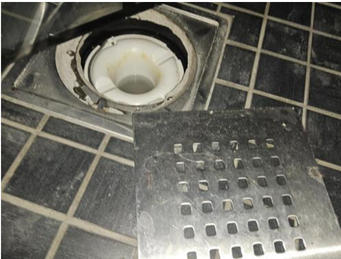
Avløpsrør (ink. sluk) - [Sluk bad 1. etg.]
