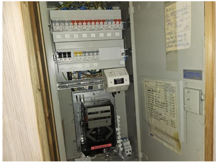
Elektrisk anlegg - [Sikringskap 1. etg]
