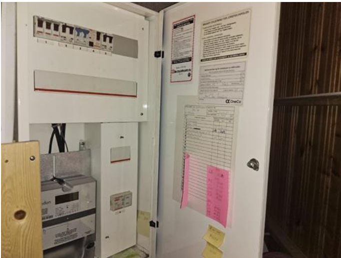
Elektrisk anlegg - [Sirkingskap kjeller]
