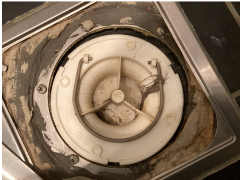
Bilde av sluk.
