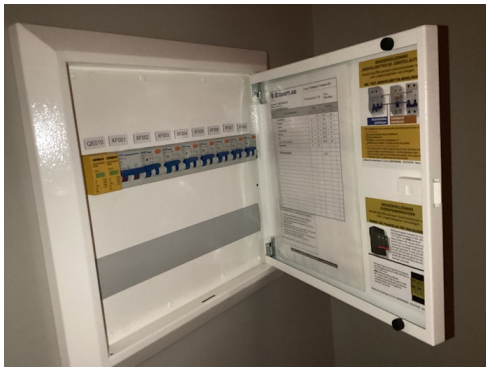
Bilde av sikringskap
