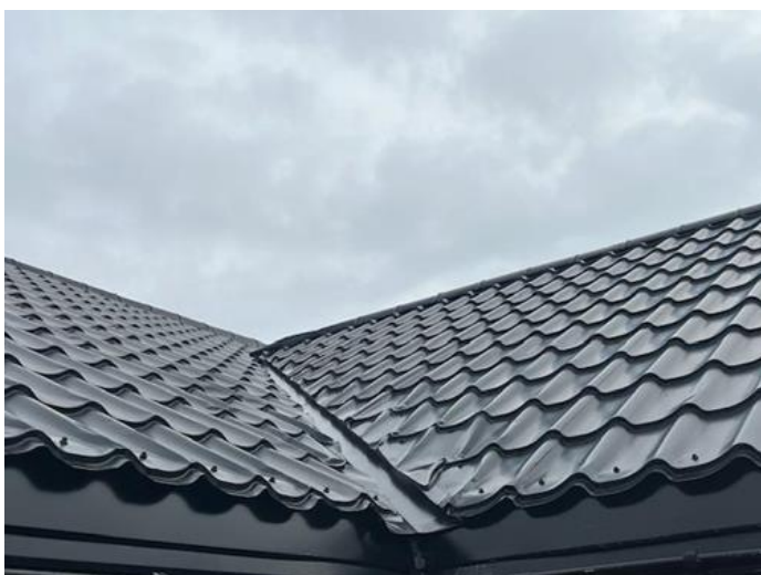
Beskrivelse - [Skader på takplater]
