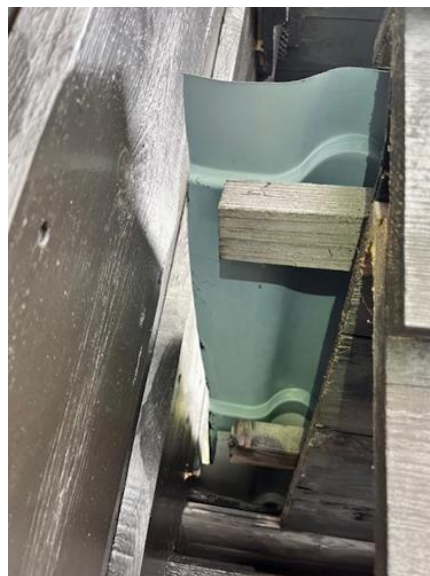
Beskrivelse - [Eksempel på mangelfull utførelse]
