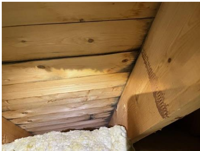
Konstruksjonsoppbygging - [Fuktmerker på kneloft]
