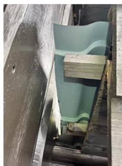
Fagmessig utførelse - Eksempel på mangelfull utførelse
