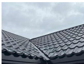
Tekking (med tilhørende beslag) - Skader på takplater
