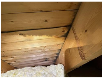
Konstruksjonsoppbygging - Fuktmerker på kneloft
