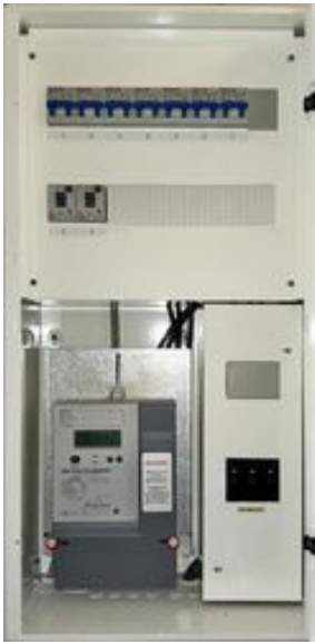
Forenklet vurdering av det elektriske anlegget - [Sikringskap]
