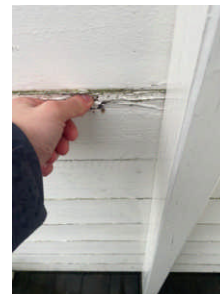
Det er råte i rekkverk og levegg.
