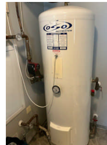
Varmtvannsbereder med varme til vannbåren gulvvarme.
