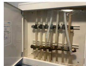
Bildet viser rør-i-rør skap. Det er klargjort for vanninstallasjoner på loft.
