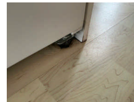
Dekksider ved kjøleskap med begynnende skader.
