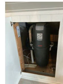
Sentralstøvsuger etablert i knevegg på loftstue.
