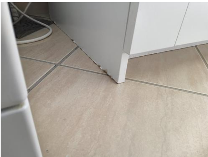
Sanitærutstyr / innredning - [Innredningen på vaskerom ]
