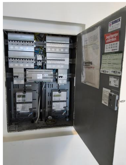
Elektrisk anlegg - [Sikringskap ]
