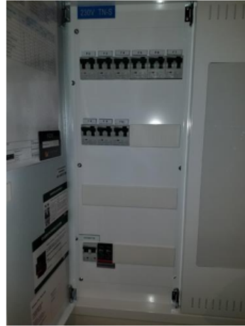
Elektrisk anlegg - [Sikringsskap ]
