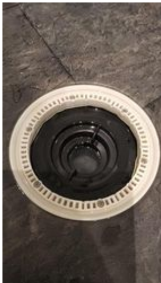
Avløpsrør (ink. sluk) - [Sluk bad]
