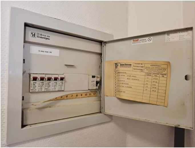
Elektrisk anlegg - [IMG_20250307_104224]
