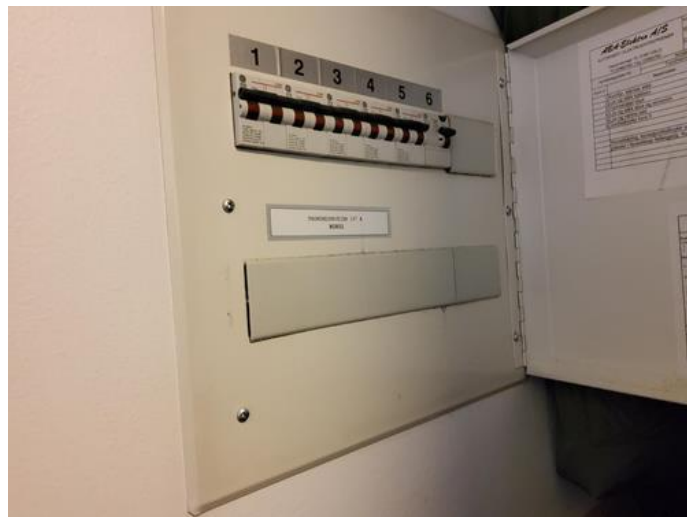
Elektrisk anlegg - [Sikringsskap ]
