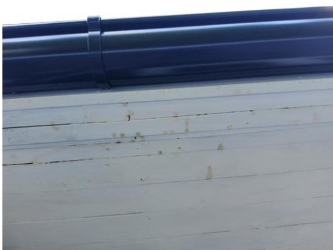
Kommentar - [Fuktmerker i gesims under veranda i 2.etasje]
