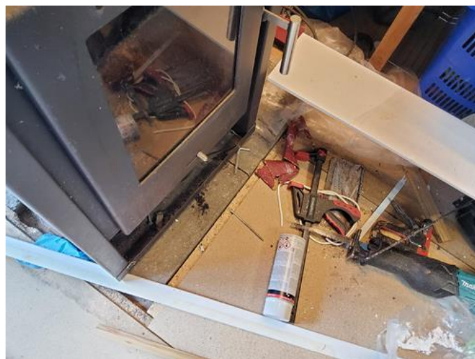
Ildsteder inne i boligen - [Manglende ubrennbar plate]
