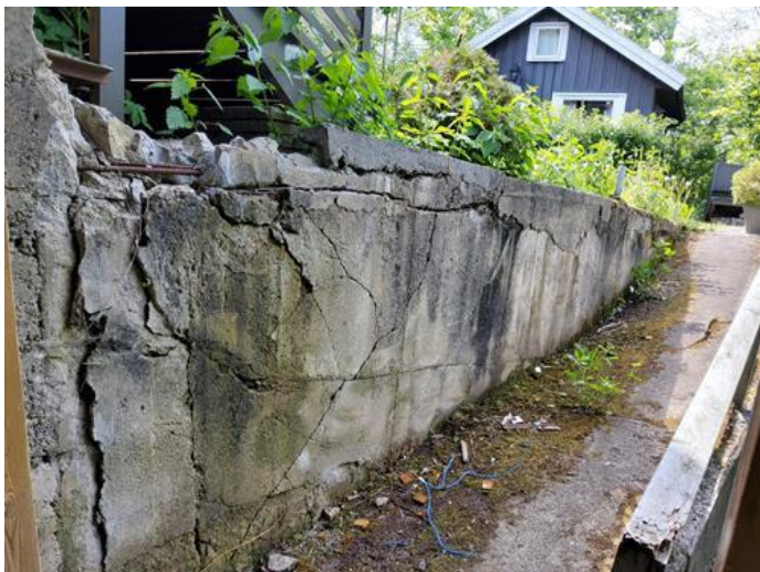
Forstøtningsmurer - [Eksempel på skader på støtemur]
