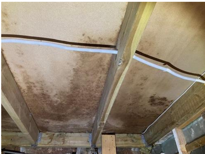
Beskrivelse - [Eksempel på lekkasje fra veranda]
