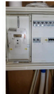
Elektrisk anlegg - [Sikringskapp]
