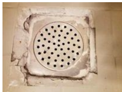
Toalettrom (ikke våtrom) - [Sluk i toalettrom.]
