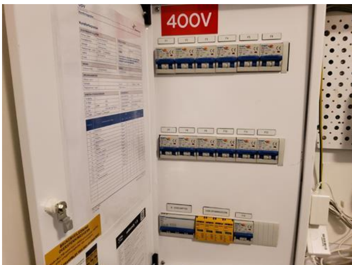
Elektrisk anlegg - [Sikringskap ]
