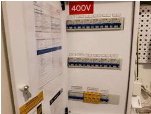
Elektrisk anlegg - [Sikringskap ]
