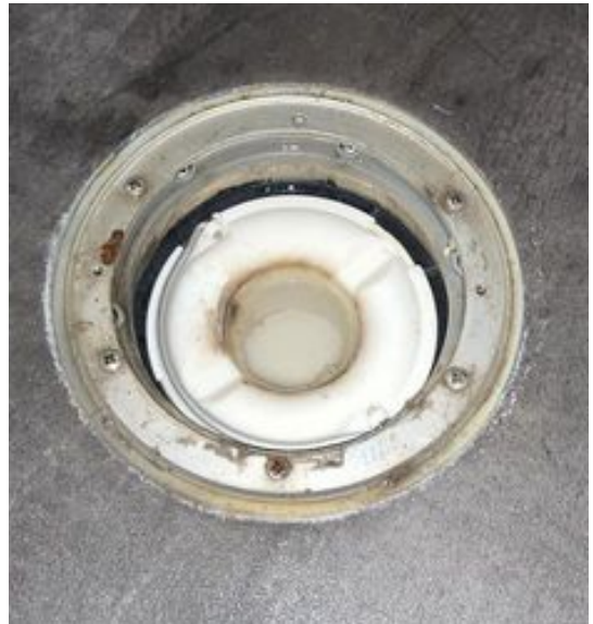
Avløpsrør (ink. sluk) - [Sluk bad]
