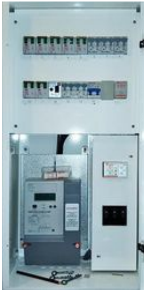
Forenklet vurdering av det elektriske anlegget - [Sikringskap]
