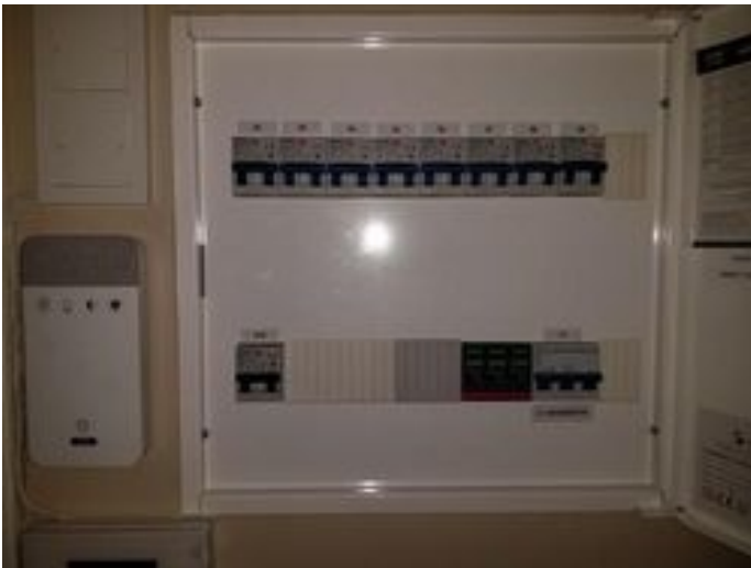
Elektrisk anlegg - [Sikringsskap.]
