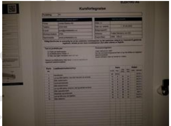
Elektrisk anlegg - [Kursfortegnelse.]
