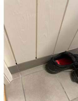
Åpning mellom kantflis og vegg
