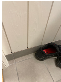
Åpning mellom kantflis og vegg
