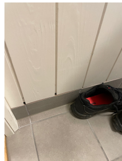
Åpning mellom kantflis og vegg
