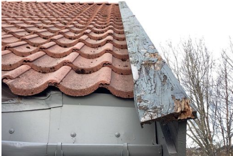
Eksempel på råteskade
