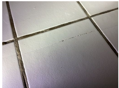
Eksempel på sprukket flis
