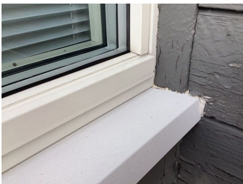
Eksempel på manglende åpning mellom beslag og bordkledning/ omrammingsbord
