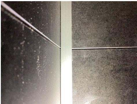
Eksempel på manglende fuging
