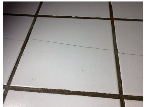
Eksempel på sprukket flis
