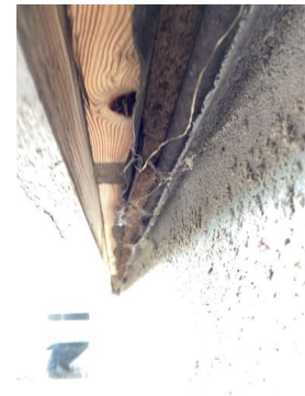
Eksempel på manglende lufting av bordkledning.
