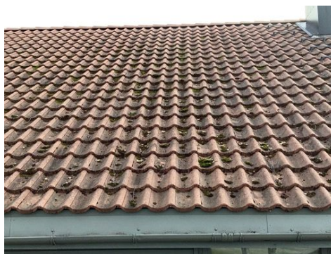
Taktekkingen har mose og slitasje på grunn av elde.
