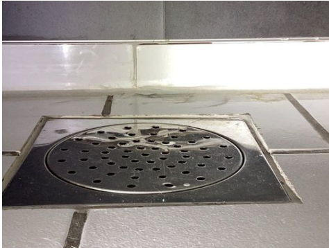
Eksempel på manglende fuging
