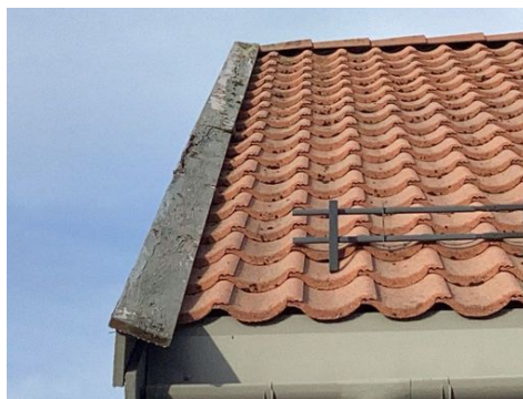
Eksempel på råteskade
