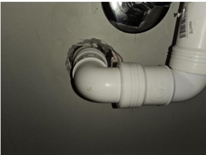
Våtrom - [Utettheter rundt avløpsrør i våtsone.]
