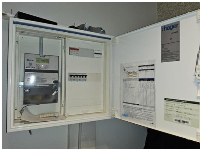
Elektrisk anlegg - [Sikringsskap 1. etg.]
