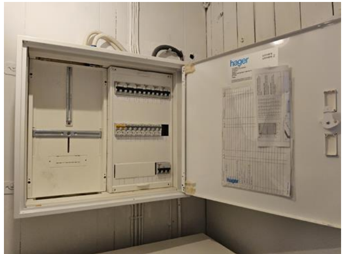
Elektrisk anlegg - [Sikringsskap loft.]
