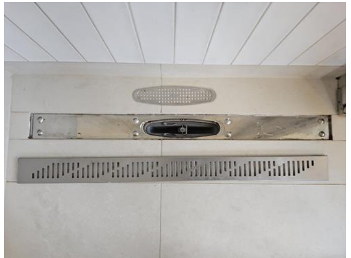
Våtrom - [Sluk bad.]
