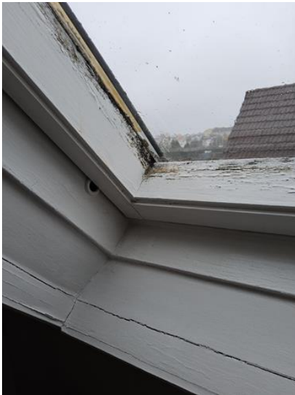
Dører og vinduer - [Fuktmerker takvindu.]
