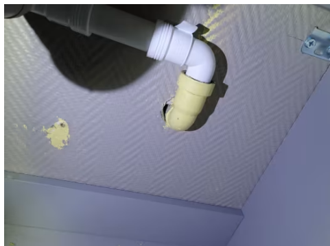
Utett rørgjennomføring i vegg under servant.
