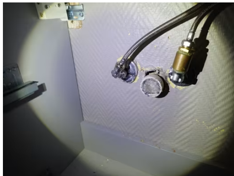
Utett rørgjennomføring i vegg under servant.
