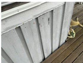
Bordkledning med skade.
