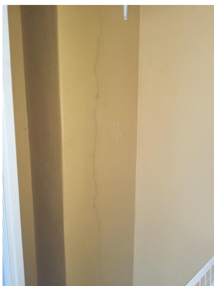
Kommentar - [Riss/sprekk skorstein ]
