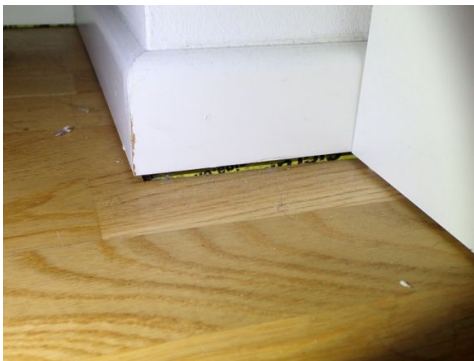
Glipper mellom gulv/gulvlist (ved pipa)
