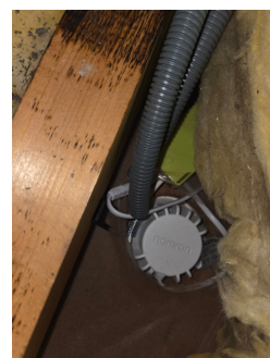
Brudd på dampsperre ved spotter over bad. På bad må det monteres tette spottkasser for å sikre tilstrekkelig dampetthet mot kaldloftet. Det er montert pakning mellom spotter og takplate som ekstra sikring og for å redusere damp gjennomgang.
