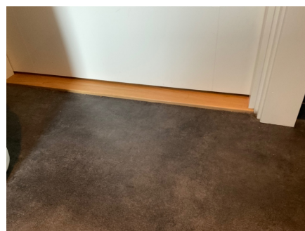
Tilluftsspalte under dør
