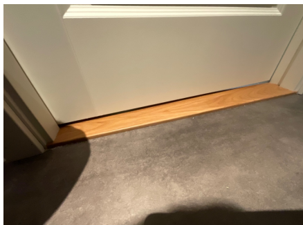
Tilluftsspalte under dør
