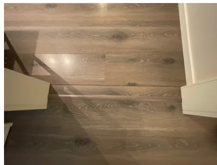
Sprekk i laminat skjøt mellom stue og kjøkken i leiligheten
