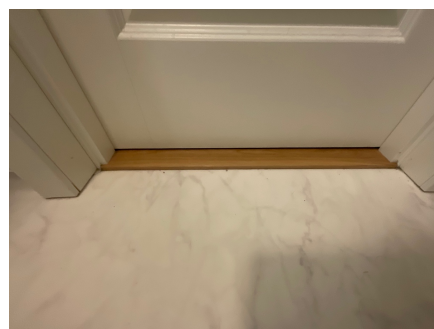
Tilluftsspalte under dør
