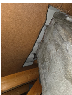
Manglende mansjett rundt gjennomføringer i undertak
