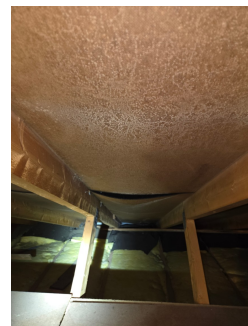
Noe begrenset ventilering ut mot raftekasser ved overgang tak/vegg
