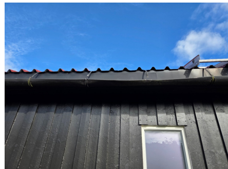
Nedbøyd takrenne på baksiden med skade på overband og rennekrok
