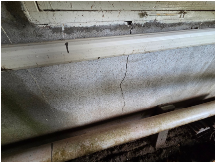
Sprekk i mur/puss under vindu på kjøkken til leiligheten
