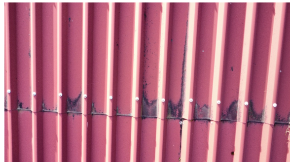
Det er noe synlig rust/avskaling av lakk på takplater
