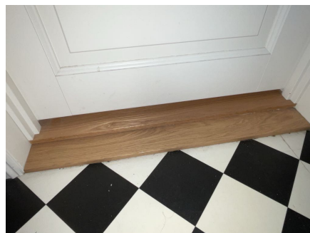
Tilluftsspalte under dør
