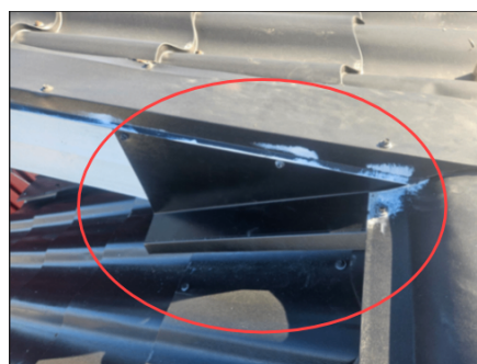
Fuktskader på undertak og sperre ved overgang mellom bolig og tilbygget bod på baksiden av boligen. Synlig fra bod. Årsak er utbedret etter befaringen med nytt beslag for å sikre avrenning via utvendig taktekking. Bilde tilsendt av selger.
