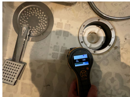
Fuktsøk er utført på gulv uten forhøyede fuktavvik ved sluk i dusj
