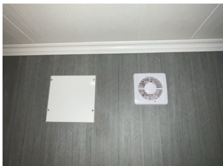
Avtrekksvifte på vegg
