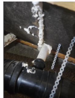
Selger har tettet åpning i stubbeloftsplate og festet plate etter befaringen. Bilde tilsendt av selger
