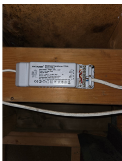
Trafo for spotter montert på taksperre i utebod har åpne koblinger
