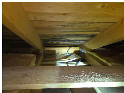
Eldre fuktmerker i underpanel over stue. Nytt tak er montert som følge av lekkasje og årsak er utbedret. Isolasjon er lagt tilbake på befaringsdagen av selger
