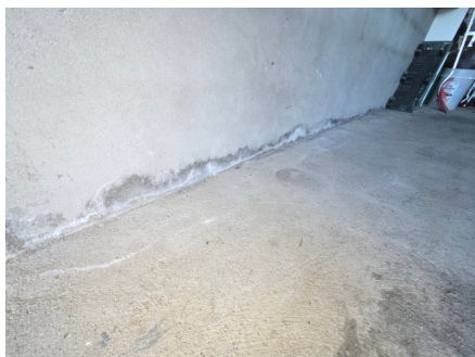
Synlig saltutslag i vegg mellom garasje og bolig
