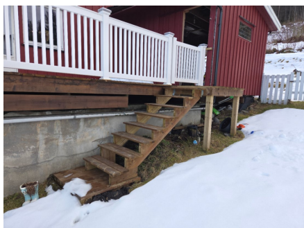
Trapp fra veranda. Bilde tatt på befaringdagen
