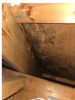
Fuktskader på undertak og sperre ved overgang mellom bolig og tilbygget bod på baksiden av boligen. Synlig fra bod. Årsak er utbedret etter befaringen med nytt beslag for å sikre avrenning via utvendig taktekking
