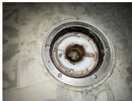
Sluk under servantskap
