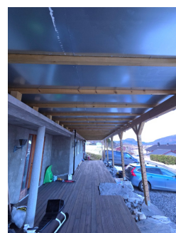
Bilde viser avrenningsplater sett fra terrasse i underetasjen. Etter befaringen har selger montert nedløpsrør.
