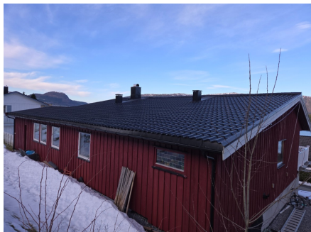
Oversikt beslag på baksiden som er montert 2006. Mangler snøfangere
