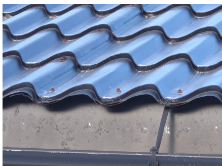
Noe rust i plateskjøter og på skruer.
