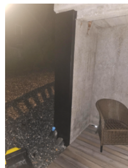
Etter befaringen har selger fått montert beslag for å beskytte styropor som ikke var tildekket ved befaringen. Bilde tilsendt av selger
