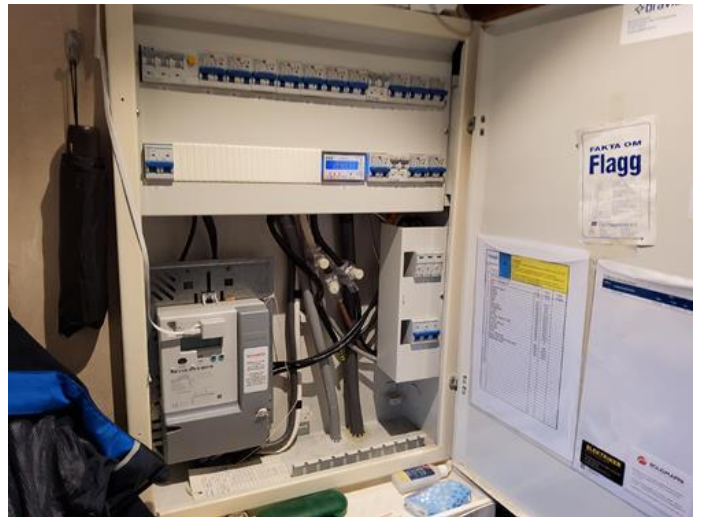
Elektrisk anlegg - [Sikringsskap ]
