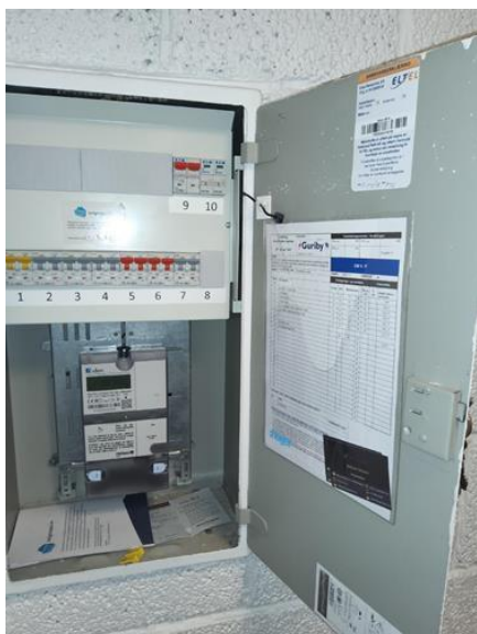
Elektrisk anlegg - [Sikringsskap ]
