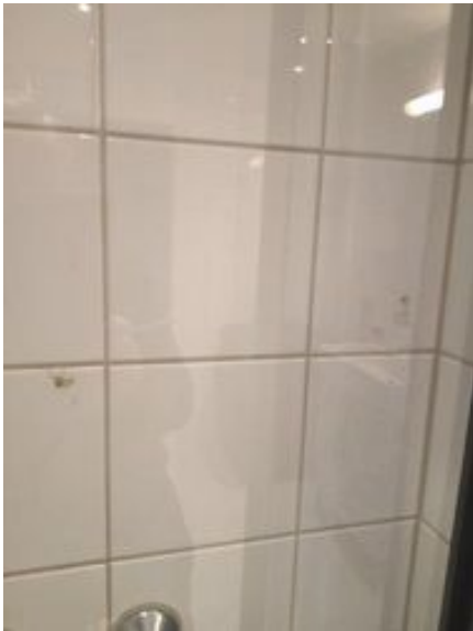
Overflater vegger - [Hull i fliser bak dusjkabinett ]
