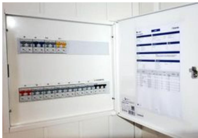
Elektrisk anlegg - [sikringskap]
