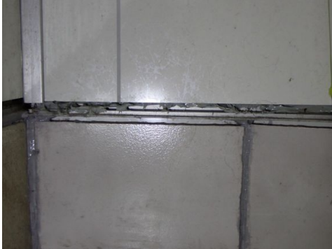
Eksempel på manglende fugging
