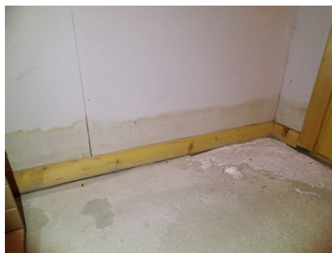
Fuktmerker i nedkant av plater
