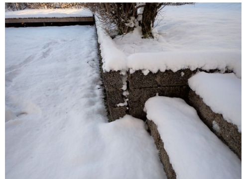
Støttemur heller utover
