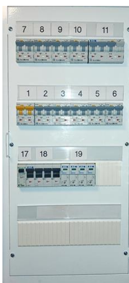
Forenklet vurdering av det elektriske anlegget - [Sikringsskap]
