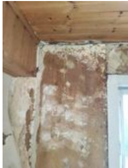
Beskrivelse - [Fuktskader vegg stue]
