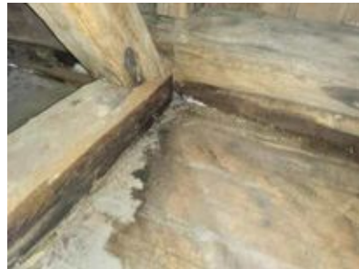
Kommentar - [Fukt og råteskader råloft]
