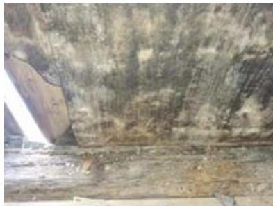
Kommentar - [Råteskade bærende konstruksjon]
