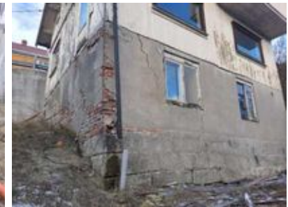
Kommentar - [Omfattende sprekker og skjevheter grunnmur]
