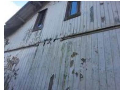
Kommentar - [Utvendig fasader]
