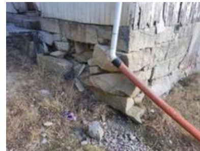
Kommentar - [Utglidning og skjevheter grunnmur]
