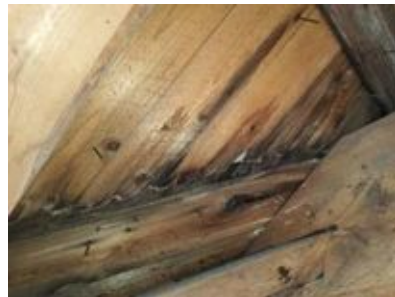
Kommentar - [Råteskader undertak]
