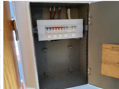
Elektrisk anlegg - [Sikringskap]
