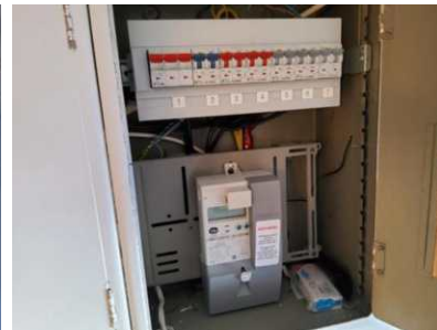
Elektrisk anlegg - [Sikringskap]
