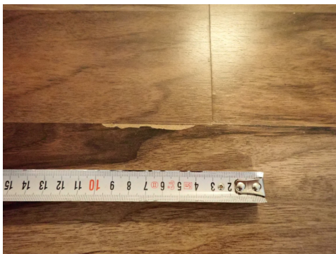
Eksempel på skade ved skjøt, laminat
