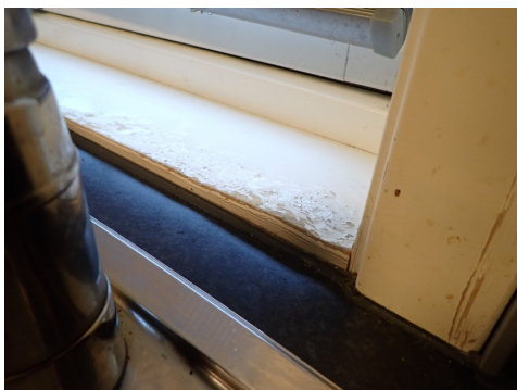
Skade i utforing, kjøkken
