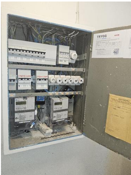
Elektrisk anlegg - [Sikringsskap med skrusikringer og automatsikringer plassert i felles gang]
