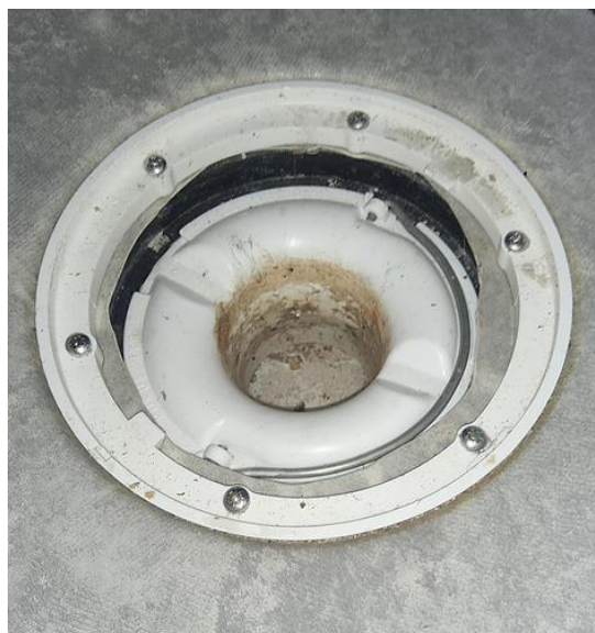
Avløpsrør (ink. sluk) - [Sluk vaskerom]
