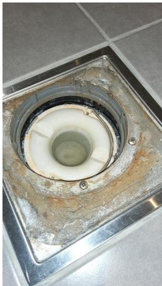
Avløpsrør (ink. sluk) - [Sluk bad]
