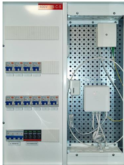
Forenklet vurdering av det elektriske anlegget - [Sikringsskap]
