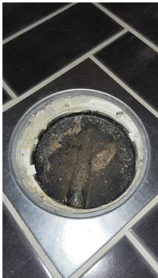
Avløpsrør (ink. sluk) - [Sluk bad]
