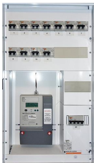
Forenklet vurdering av det elektriske anlegget - [Sikringskap]
