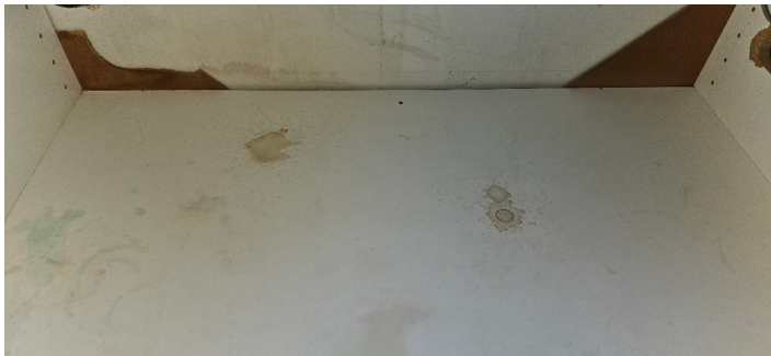
Mindre lekkasje i underskap under vask
