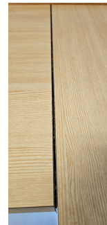
Glippe i skjøt mellom benkeplater
