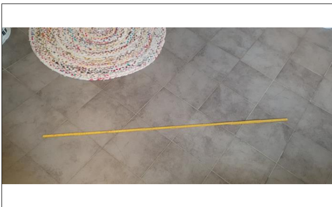
Bildet viser lengde på synlig sprekk i fliser.
