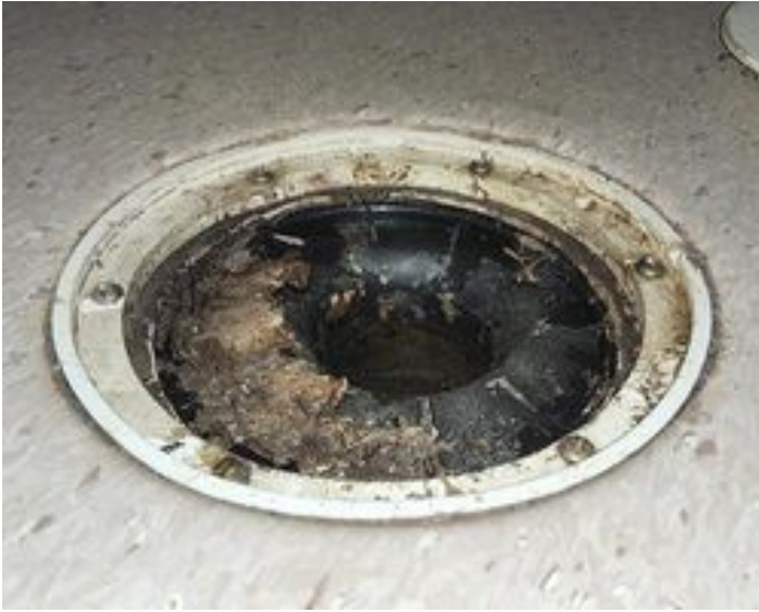
Avløpsrør (ink. sluk) - [Sluk bad]
