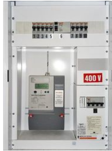
Forenklet vurdering av det elektriske anlegget - [Sikringskap]
