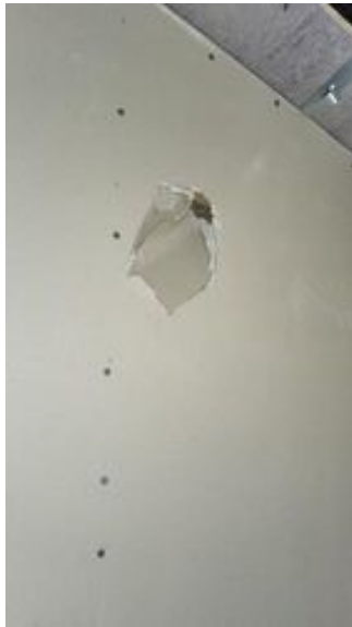
Branntekniske vurderinger - [Skadet brannskillet]
