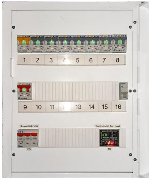
Forenklet vurdering av det elektriske anlegget - [Sikringskap]
